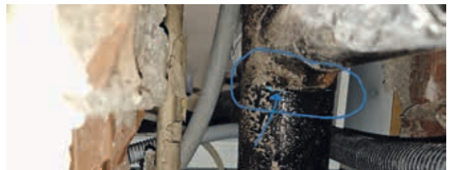
Neutrottenstrasse undichte Stelle
